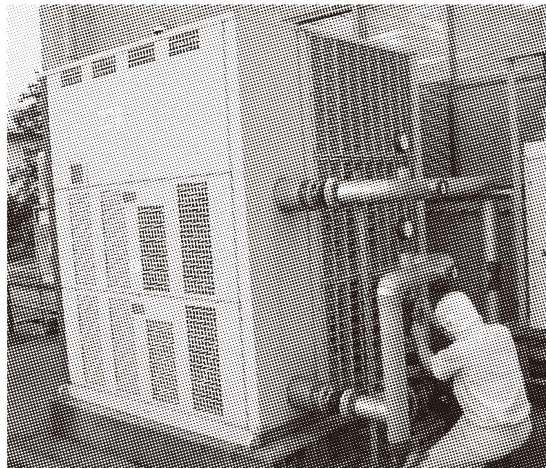
津幡工場に導入した空冷ヒートポンプチラー
